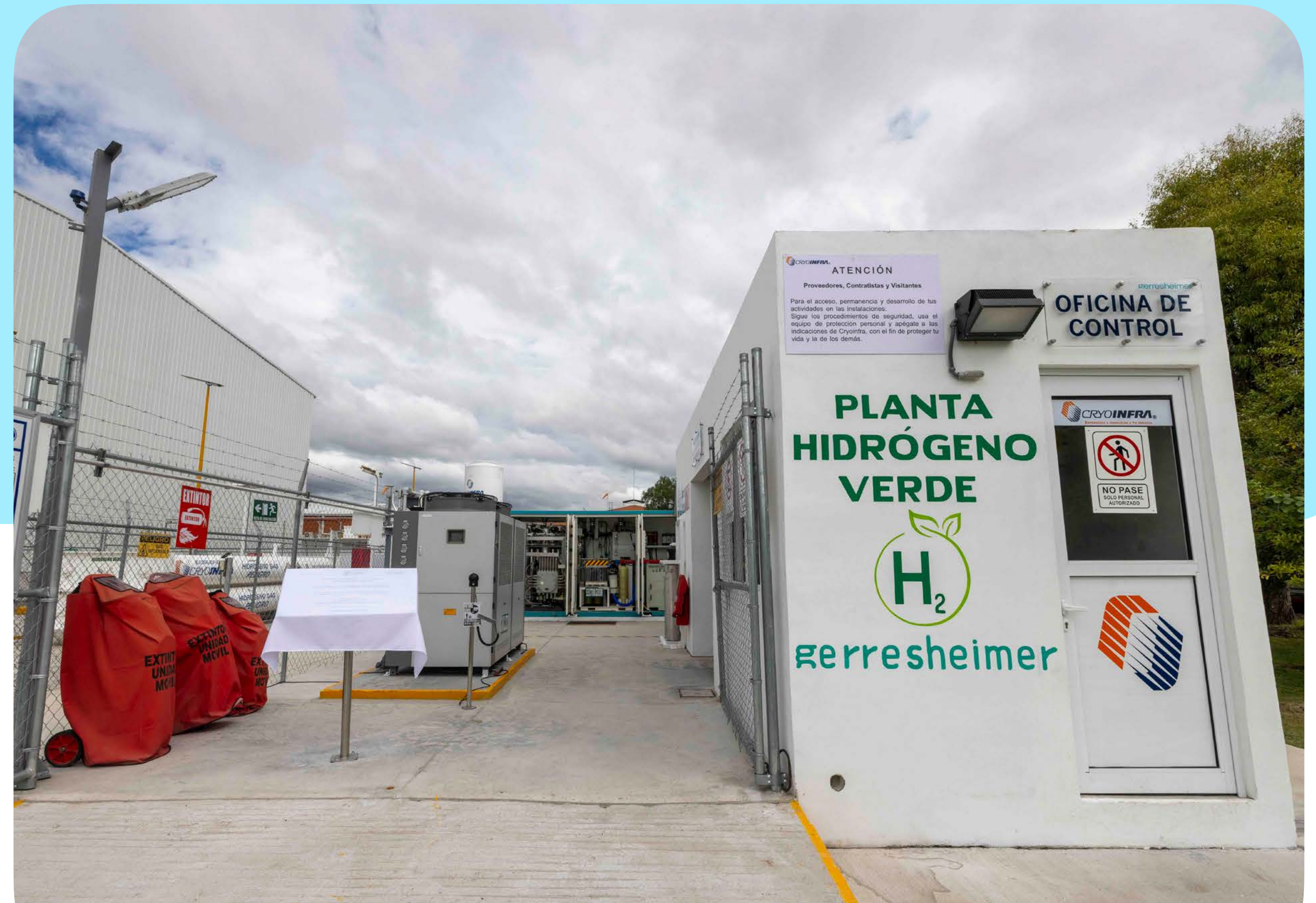
Planta de Cryoinfra para la producción Hidrógeno Verde en Querétaro 2025
